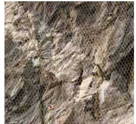
Detalle de la afección de la esquistosidad sobre las margas y una capa de calcarenita.
