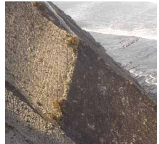
Detalle del deslizamiento capa a capa que genera la caída de bloques.
