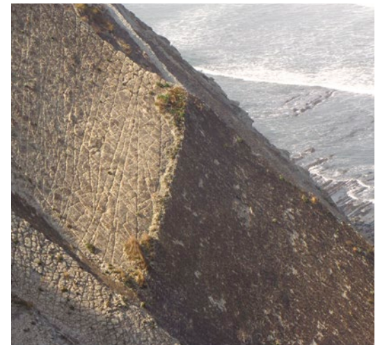
Detalle del deslizamiento capa a capa que genera la caída de bloques.
